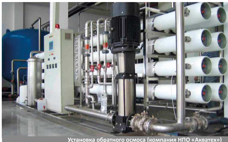
Установка обратного осмоса (компания НПО «Акватех»)
